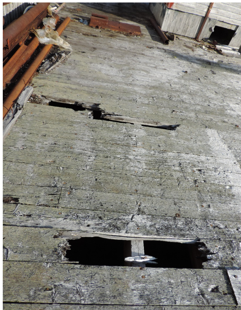
Figur 0.18 Brygge/kaj anlæg B-12. Plankerne rådner og knækker ved belastning, selvom de oprindeligt er 50 mm tykke. Se også figur 0.22.
