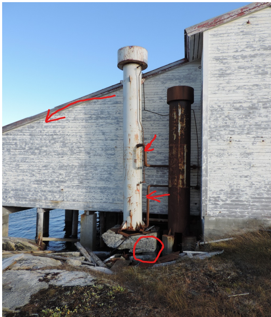
Figur 0.19 Frysehus og lager B-8. Stålkorsten ved bådrampen. Havet har gennemtæret beton og armering i soklen. Der står kun ca. 15 cm beton tilbage (se cirkel) og skorstenen hænger i to metalrør. Akut sammenstyrtningsfare.
