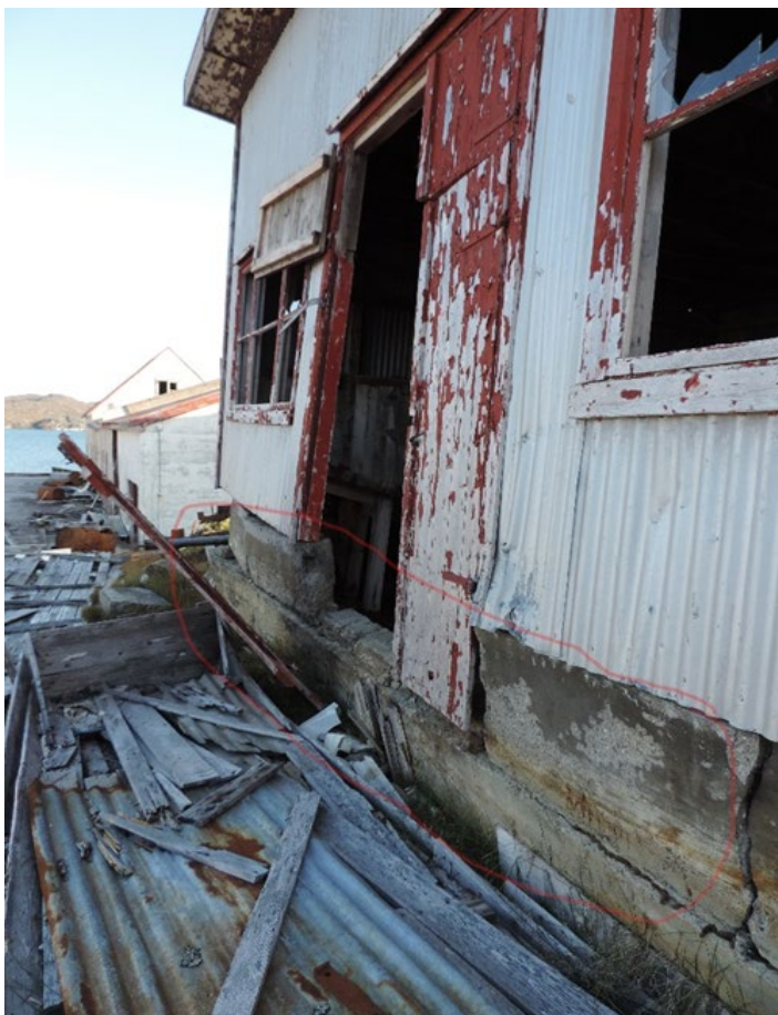
Figur 0.1 Ildsmedje B-9. Fundamentet kollapse og skubbes udad
