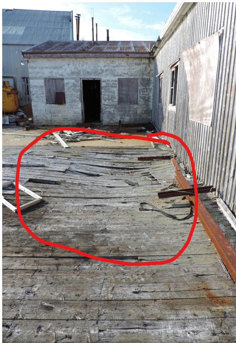
Figur 0.17 Brygge/kaj anlæg B-12. Bryggens planker og understøtning rådner og kollapseder.
